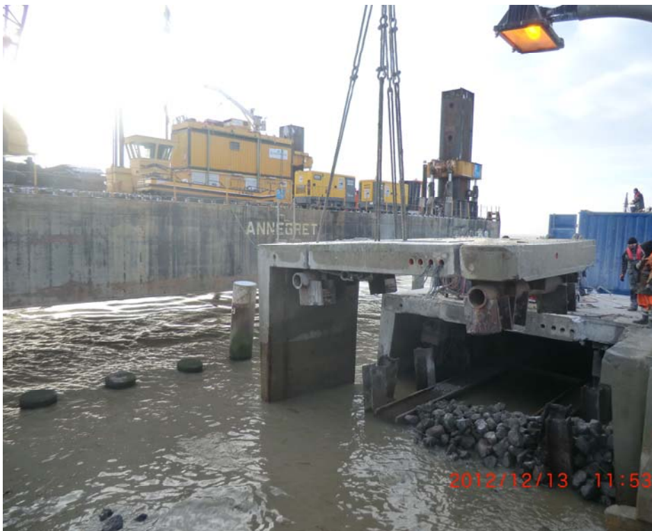
Abb.15 Nachdem die Stahlpfähle der Unterkonstruktion durchgebrannt wurden, ...
