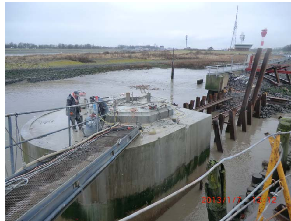
Abb.4 Die Brüstung am Molenkopf und zwei weitere Betonelemente sind weggehoben worden
