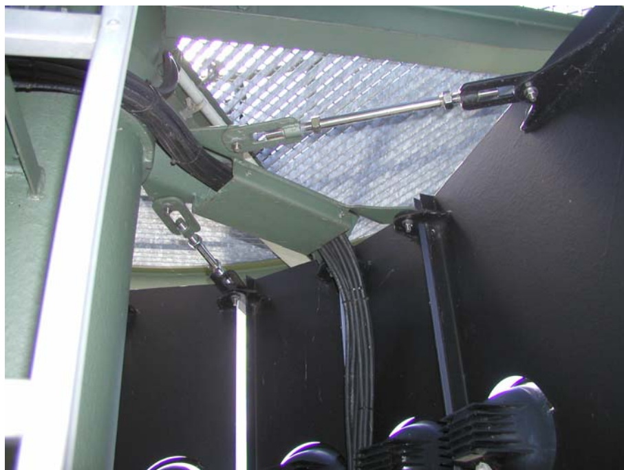
Foto: Detail LTS Weichensignalmast, Befestigungen Sichtblenden, Kabelführung, Scheinwerfer etc.
